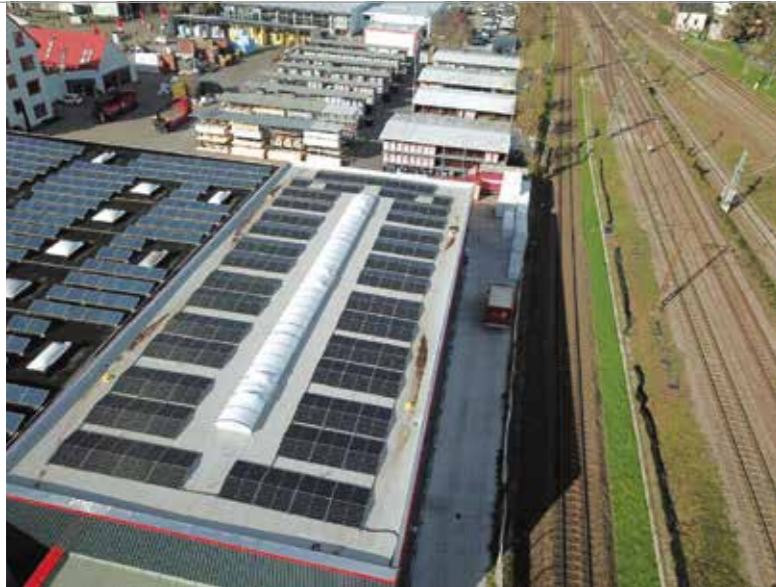
PV-Anlage mit 70 kWp Leistung für eine Lagerhalle der DE Süd Niederlassung in Mannheim.
