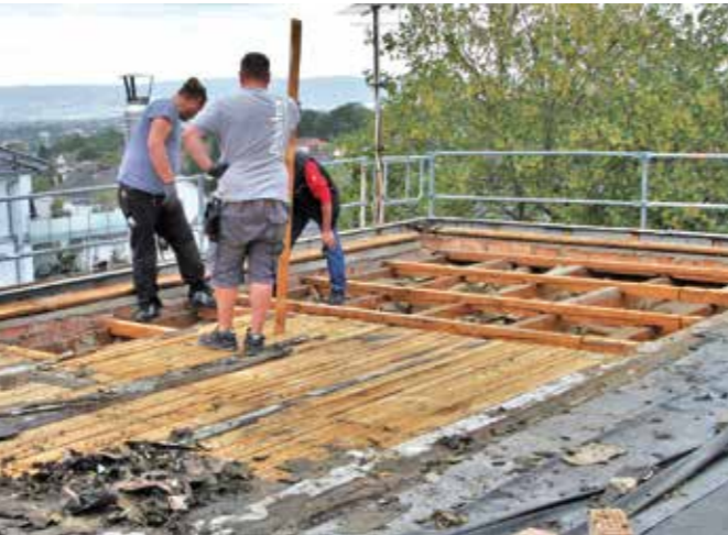
Das Team von Peter Bärwald bei den schnell begonnenen Aufräum- und Abrissarbeiten.
