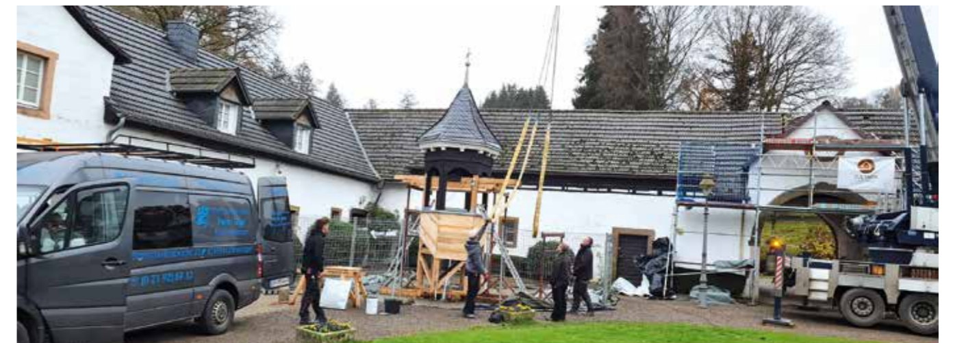
Da ist die Arbeit am Holzturm fast vollendet. Mithilfe des Krans wird er wieder neu an seinen alten Standort transportiert.
