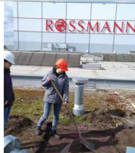
Girls'Day: Pia schwingt die Schaufel beim Abtragen einer alten Dachbegrünung auf dem Flachdach.
