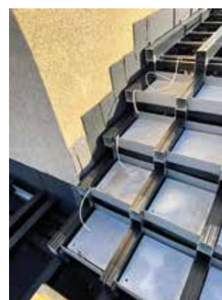
Die Unterkonstruktion für die Treppe direkt an der Wand stellte eine Herausforderung dar.
