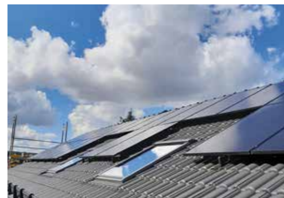
Die PV-Anlage erbringt eine Höchstleistung von 8,88 kWp mit einem Eigenverbrauchsanteil von 44,8 Prozent und einem sehr hohen Autarkiegrad von 72,9 Prozent.
