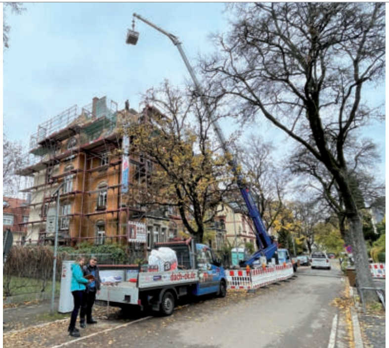
Sanierung im Bestand für Privatkunden aus der Region, auch im Bereich Denkmalschutz, ist das Kerngeschäft des Freiburger Betriebs.
