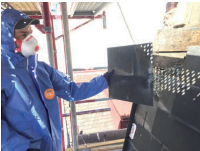
Ein Mitarbeiter entsorgt alte asbesthaltige Schieferplatten und trägt dafür die erforderliche persönliche Schutzausrüstung.
