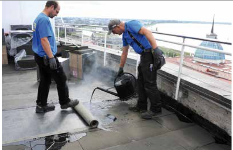
Präzises Arbeiten ist angesagt, wenn es um die Verklebung der einzelnen Schichten geht. 40 Pakete heißes Bitumen laufen durch die Gießkanne.
