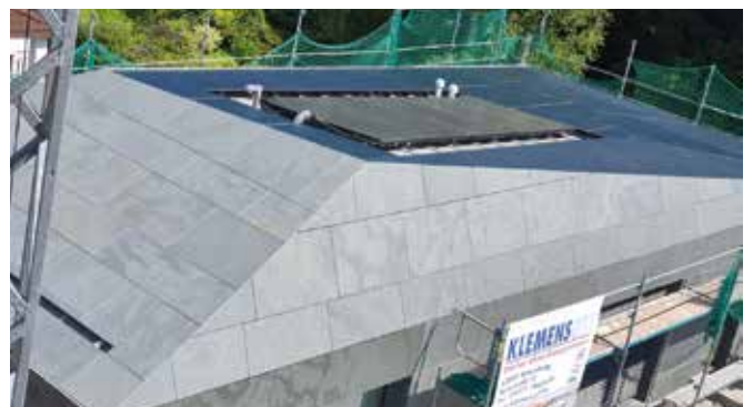
Der Schiefer – das „Urgestein“ des Dachdeckers – wurde bei diesem Objekt mit moderner Solartechnik kombiniert.
