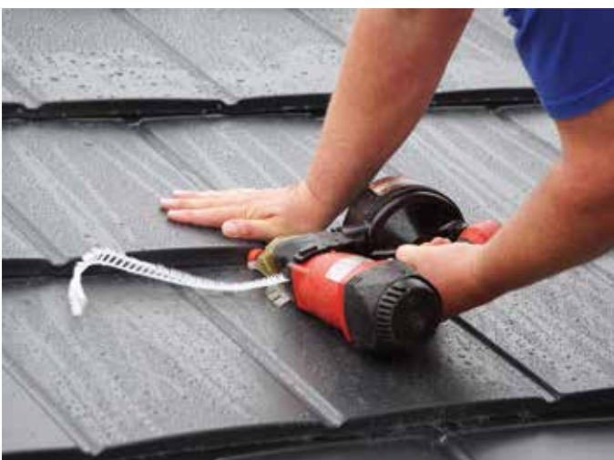
Durch die mehrfache Fixierung der einzelnen Dachplatten ist ein Plano-Dach absolut sturmsicher befestigt. Die Befestigung erfolgt maschinell mit Schraub-schussnägeln, kann aber auch manuell geschraubt werden.
