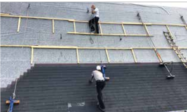
Sechs Wochen dauerte die Dachsanierung – drei bis vier Mitarbeiter waren jeweils täglich vor Ort.
