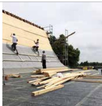
Der Dachstuhl wird von verzogenen Holzbalken getragen.
