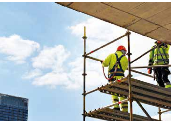
Fehlt der Seitenschutz, ist die Nutzung von PSAgA angezeigt (Auffanggurt, Verbindungsmittel und Helm mit Kinnriemen).
