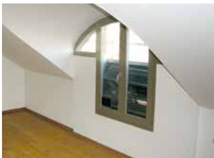
Der Hebelmechanismus der Fluchtweggaube ist nur von innen zu sehen.
