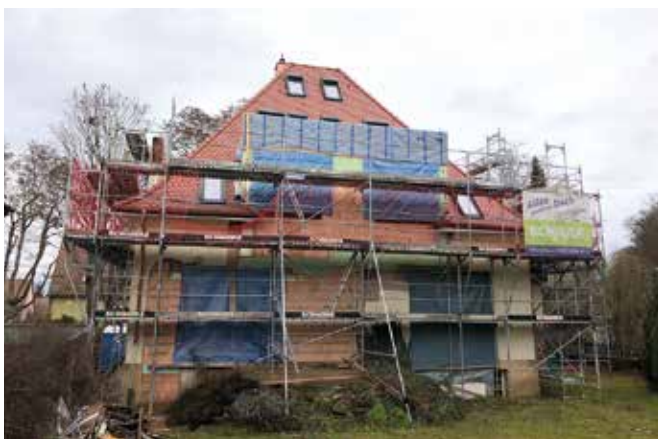
Der Architekt setzte sich für den Erhalt originaler Bauelemente wie Schiebetüren oder Fußböden ein bei dieser auch im Inneren umfangreichen Villasanierung.
