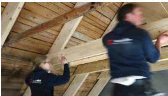
Dachstuhl sanieren in Fischerhude: Katja Wiesenmüller und ein Kollege ziehen massive Holzbalken ein.
