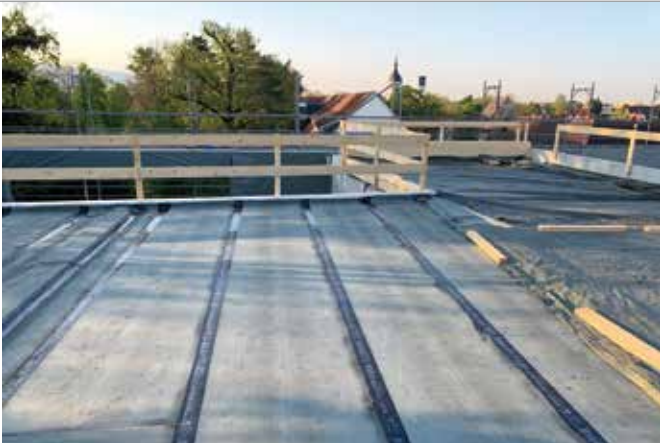
Wasserdichtes Unterdach: Die gute alte Bitumenbahn soll es richten.
