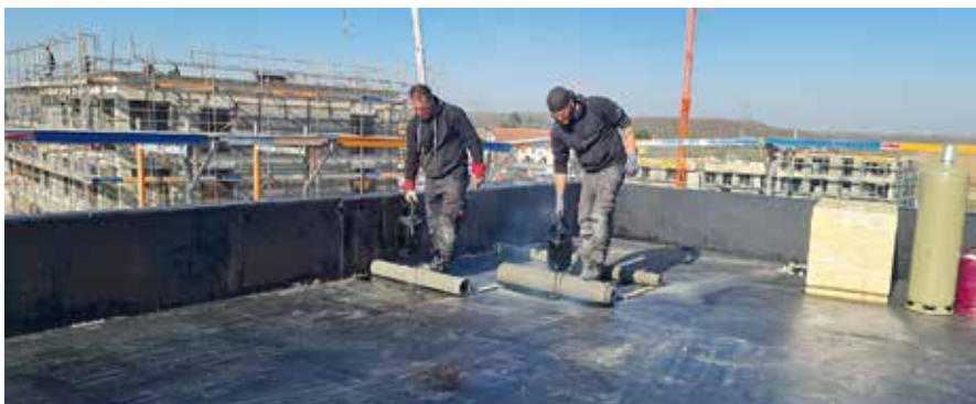
In Köln baut die GAG Immobilien AG 360 neue Wohneinheiten, alle mit unterlaufsicheren Abdichtungssystemen sowohl auf den Dachflächen als Umkehrdächer als auch auf der Tiefgarage von Overdick.
